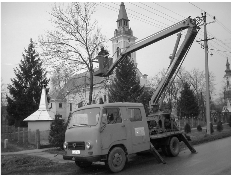
Március 9 és 12 között végezték el Bajsán a villanyvezetékeket veszélyeztető lombok nyírását.
